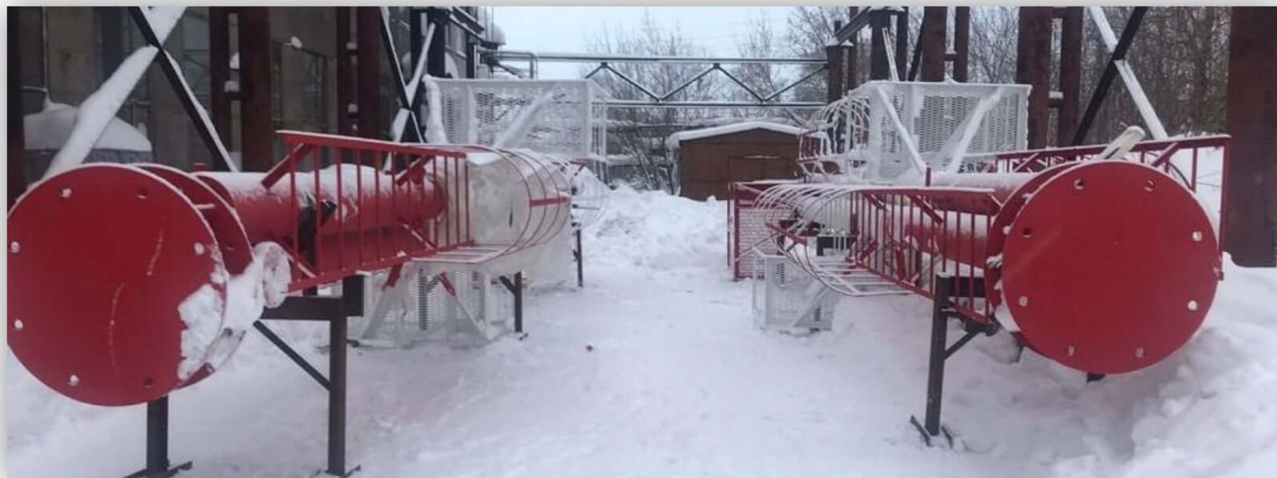
✓ ПАО «Роснефть». Вертикальная факельная установка ООО «НПП РЭС».
